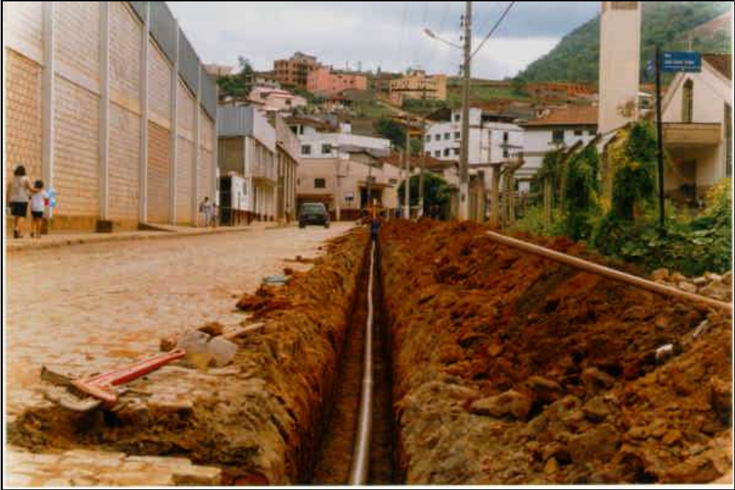
Foto 6 - Rede de Distribuição em PVC PBA
