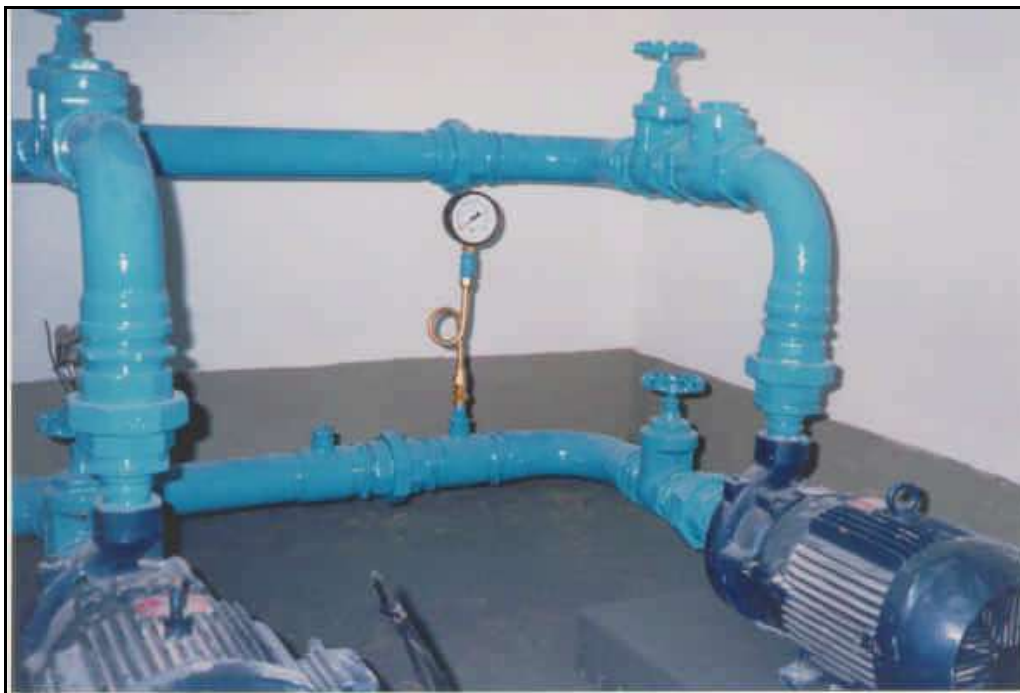
Foto 7 - Estação Elevatória de Água Tratada
