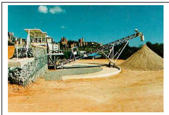
Foto 21 - Usina de Reciclagem de Entulhos
